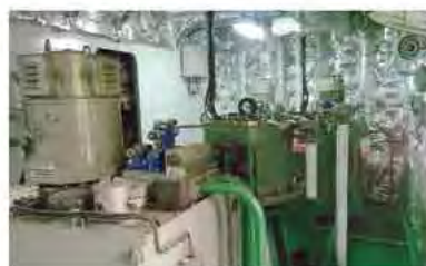
▲ 液压泵站 HPU
